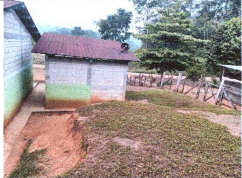
Foto 2: Se Observa: las laminas de la cocina se encuentra muy oxidados por lo que se necesita remozar.
