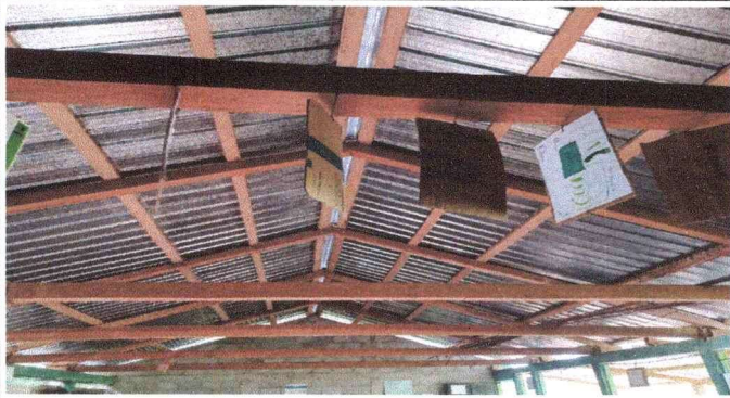
Foto1: se necesita reparacion o sustitucion del techo del aula.
