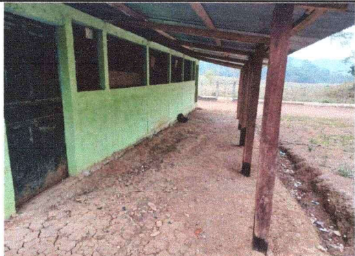
Foto 4: se necesita piso de concreto en el corredor del establecimiento sustitucion de puertas, ventos y balcones.
